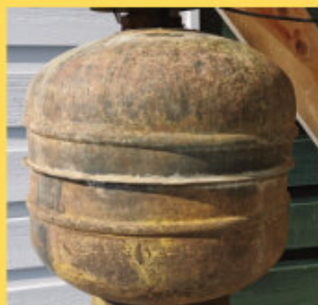
Unübersehbar: Die Schäden
